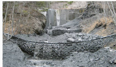
Die ausgebildeten Stufen der drei natürlich verfüllten Barrieren nach dem zweiten Murgang
