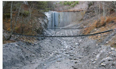
Die drei noch ungefüllten Murgang-Barrieren mit dem Staudamm im Hintergrund
