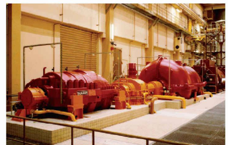
02 Der zweistufige Kompressor des Luftspeicher-Gasturbinen-Kraftwerks Huntorf. Im Hintergrund rechts schliessen Generator und Gasturbine an
