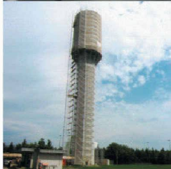
Behälter- und Bäderbau
