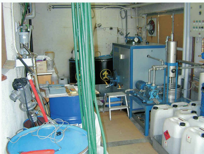
«Dauerbrenner» im betrieblichen Umweltschutz: die ordnungsgemässe Chemikalienlagerung (Bild: Awel)
