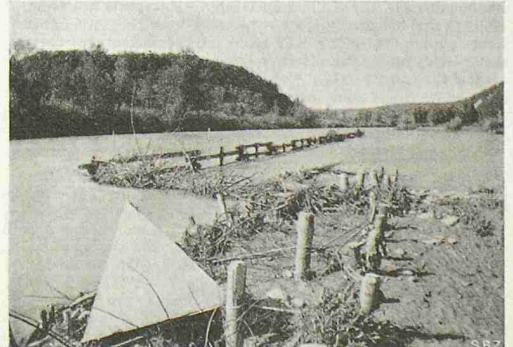
Abb. 4. Unrichtige Ausführung einer Wolf'schen Wand, mit ungünstigem Anschluss am Ufer (musste wieder entfernt werden)
