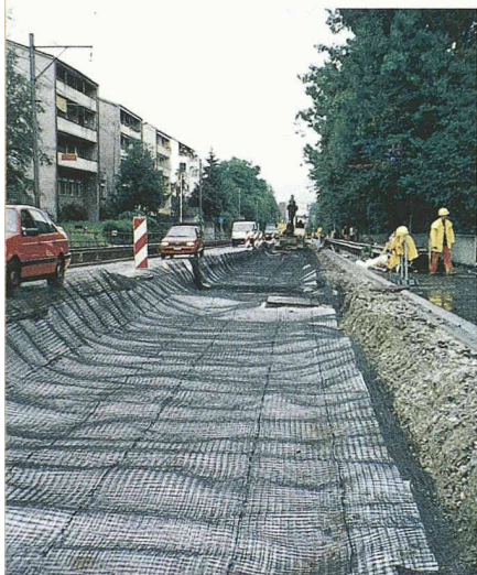
Ein fünfflagiges Geogitter über einem Geovlies ersetzt Tonnen von Kies beim Fahrbahnaufbau der Bernstrasse in Zollikofen BE
