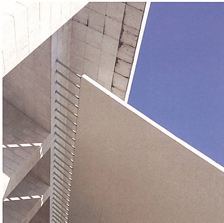
Baldachin in Lissabon: Es handelt sich nicht um eine überdrückte biegesteife Betonplatte.
