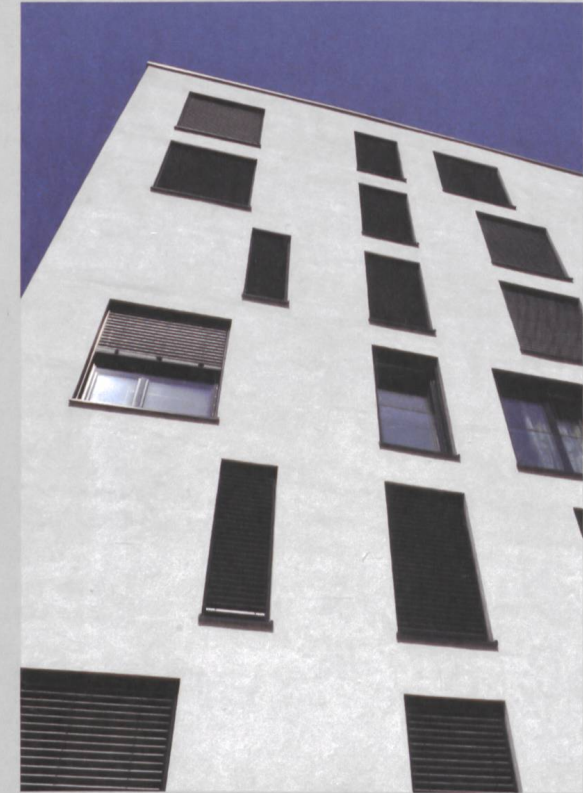
Automatisierte Storen sorgen für optimalen Hitze- und Blendschutz.
