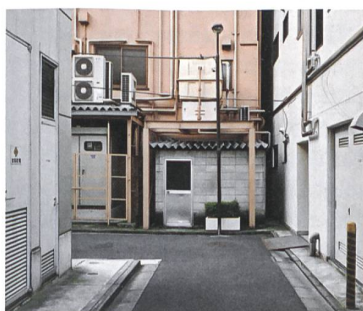
Darf's ein bisschen mehr sein? Haustechnik in Tokio.
