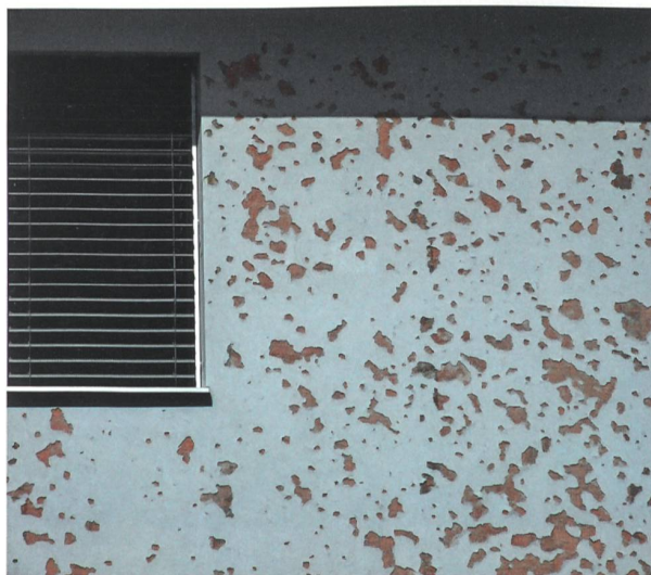
Hagelschäden am Verputz einer Fassade.
