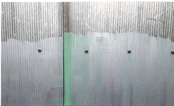
Bei der Reinigung ist nicht nur der Schmutz, sondern auch ein Teil der Lackierung entfernt worden.
