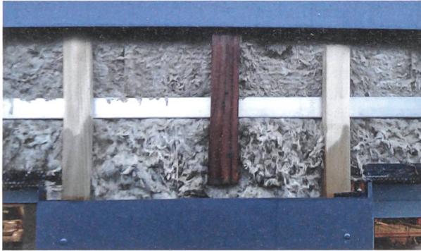
Durchnässte Holzlattung und Wärmedämmung trotz Hinterlüftung: Die EPDM-Fugenbänder wurden nicht gemäss Herstellervorgaben montiert.
