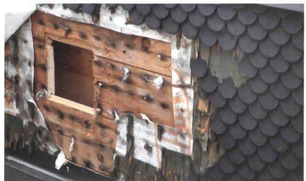
Ein zu dichter Farbanstrich auf den Holzschindeln wirkt als Diffusionssperre. Hinter den Holzschindeln staut sich Wasserdampf an und führt zum Faulen des Holzes.
