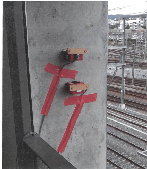
Die Spickbewegungen treten gleichzeitig mit den Knackgeräuschen auf. Die Messinstrumentierung nimmt beides auf: Horizontale Schwinggeschwindigkeitssensoren erfassen die Bewegung der Tragstruktur direkt an der Fassade, während ein Mikrofon im Innenraum (nicht im Bild) den hörenden Menschen simuliert und den abgestrahlten Körperschall bzw. das Knacken aufnimmt.
