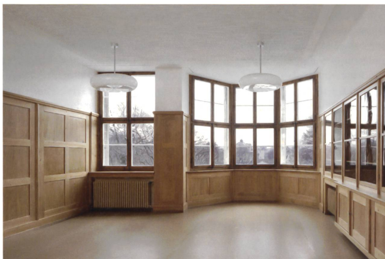
Ein Büro im Oberstufenschulhaus Quader in Chur mit neuer Erdbebenwand rechts.
