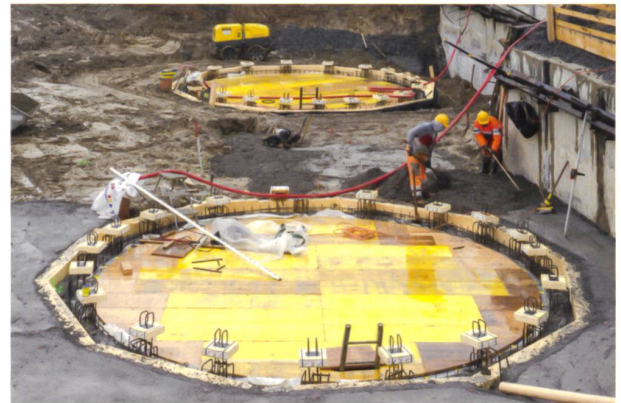
Zur Speicherung von thermischer Energie dienen zwei unterirdische Wassertanks mit einem Durchmesser von je 6 m.
