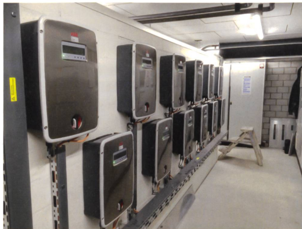
Die Wechselrichter stehen in der Energieversorgung des Mehrfamilienhauses zwischen Produktion und Verbrauch.
