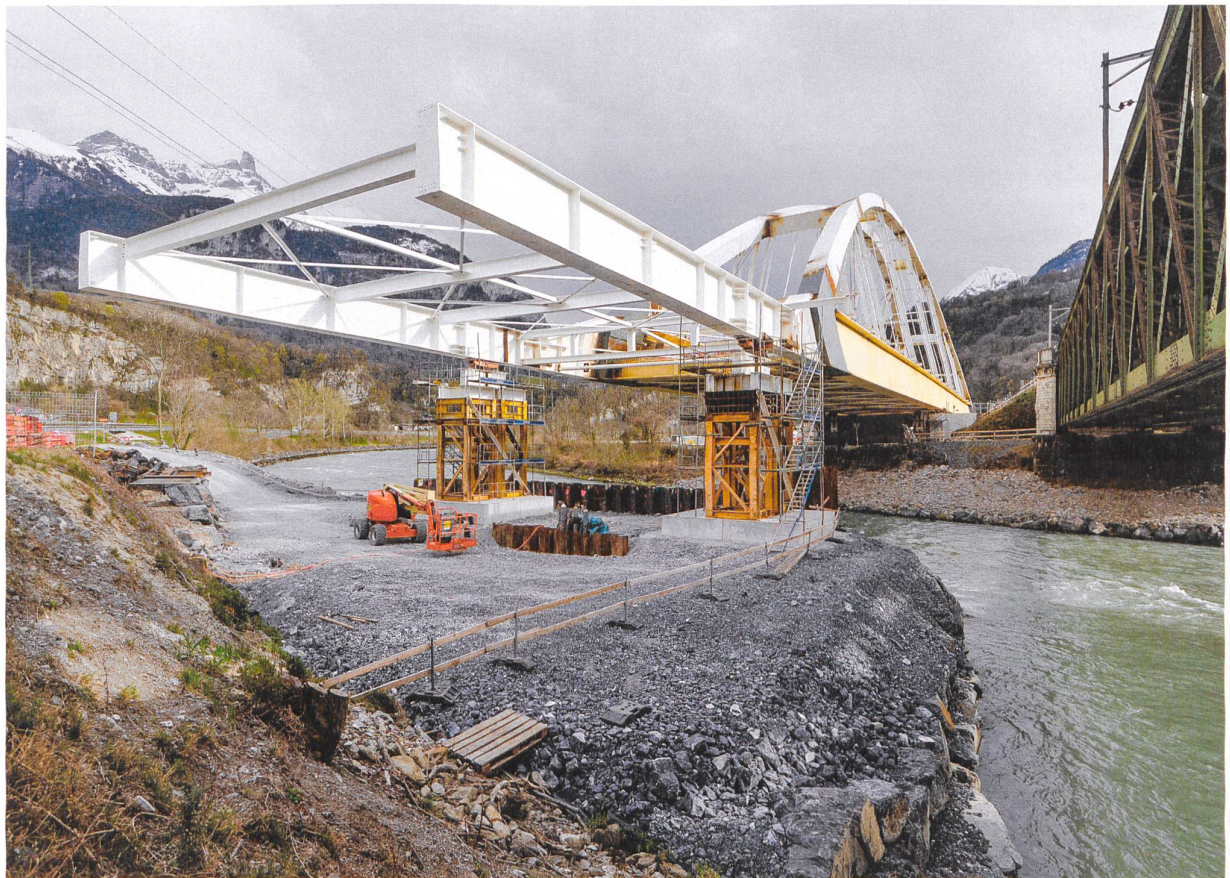
Der 30 m lange Vorbauschnabel hat die provisorischen Pfeiler am rechten Rhoneufer (Fließrichtung von links) erreicht. Nach dem weiteren Vorschub über den Fluss wird die Brücke stromabwärts gegen die bestehende Fachwerkkonstruktion verschoben.
