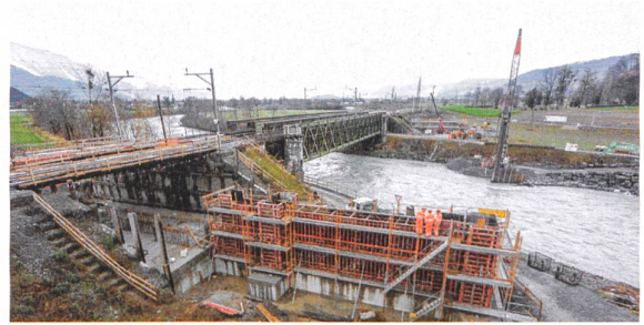
Baugrube des definitiven Widerlagers unter den Behelfsbrücken im Eisenbahndamm mit der Schalung des linksufrigen Vorschublagers.
