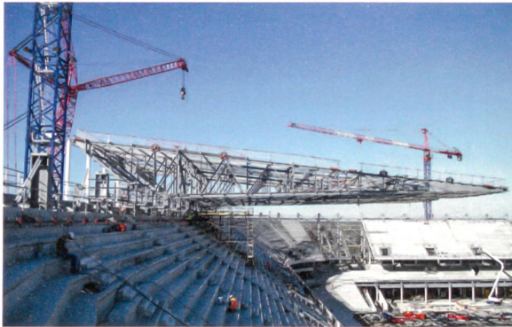
Blick auf ein Element der Stahlkonstruktion für das auskragende Stadionsdach. Das Dach hat ein Gefälle von 7°.
