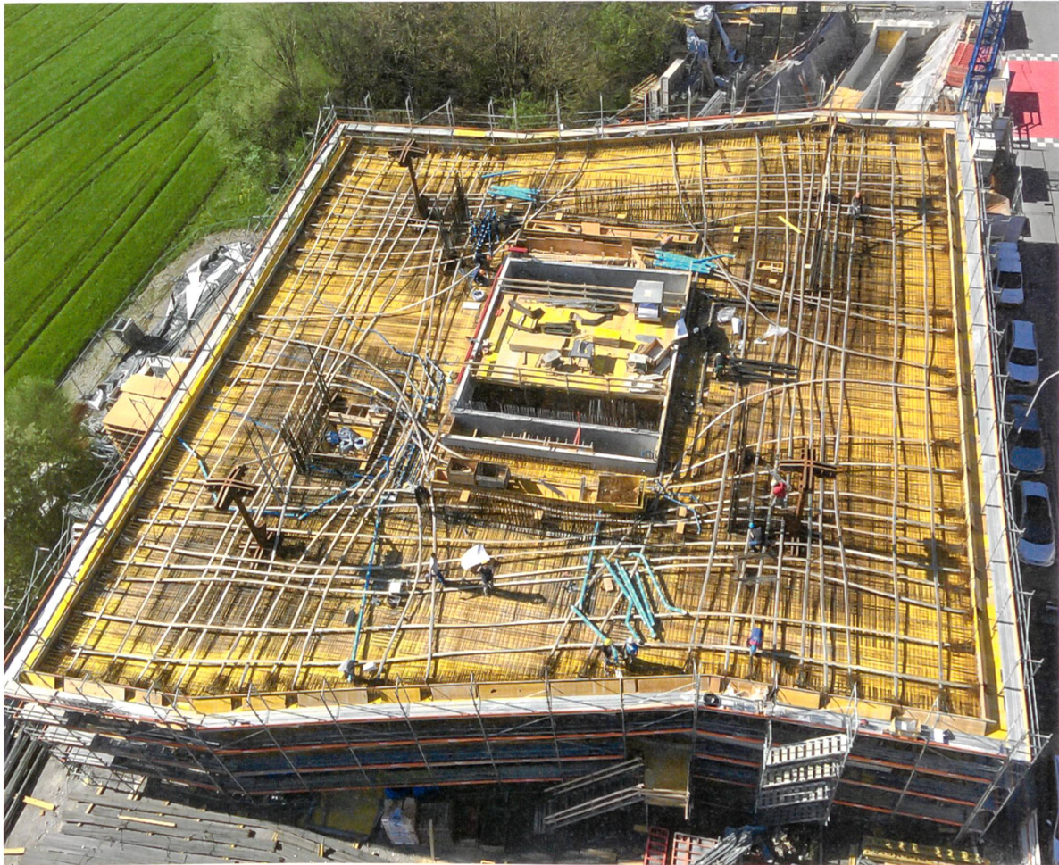
Bis zu 9.5 m statische Auskragung, Nutzlasten von 12.0 kN/m 2 und 60 cm starke Geschossdecken: Die Vorspannung der Decke mit Flachkabeln war unumgänglich, und die Spannkabel mussten in ihrer Lage und Höhe minutiös auf der Baustelle verlegt werden.
