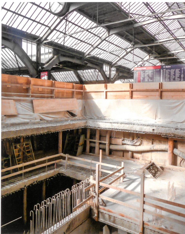
Eine Ingenieurleistung der Superlative: Bau der Durchmesserlinie Zürich mitten in der Stadt und bei vollem Bahnbetrieb.
