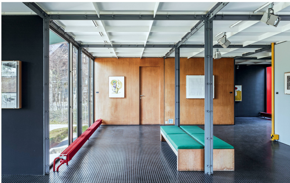
Polychromes Farbkonzept auch bei der Gebäudetechnik: Warm- und Kaltwasserleitungen sind rot und blau gestrichen, die Stromleitungen gelb.
