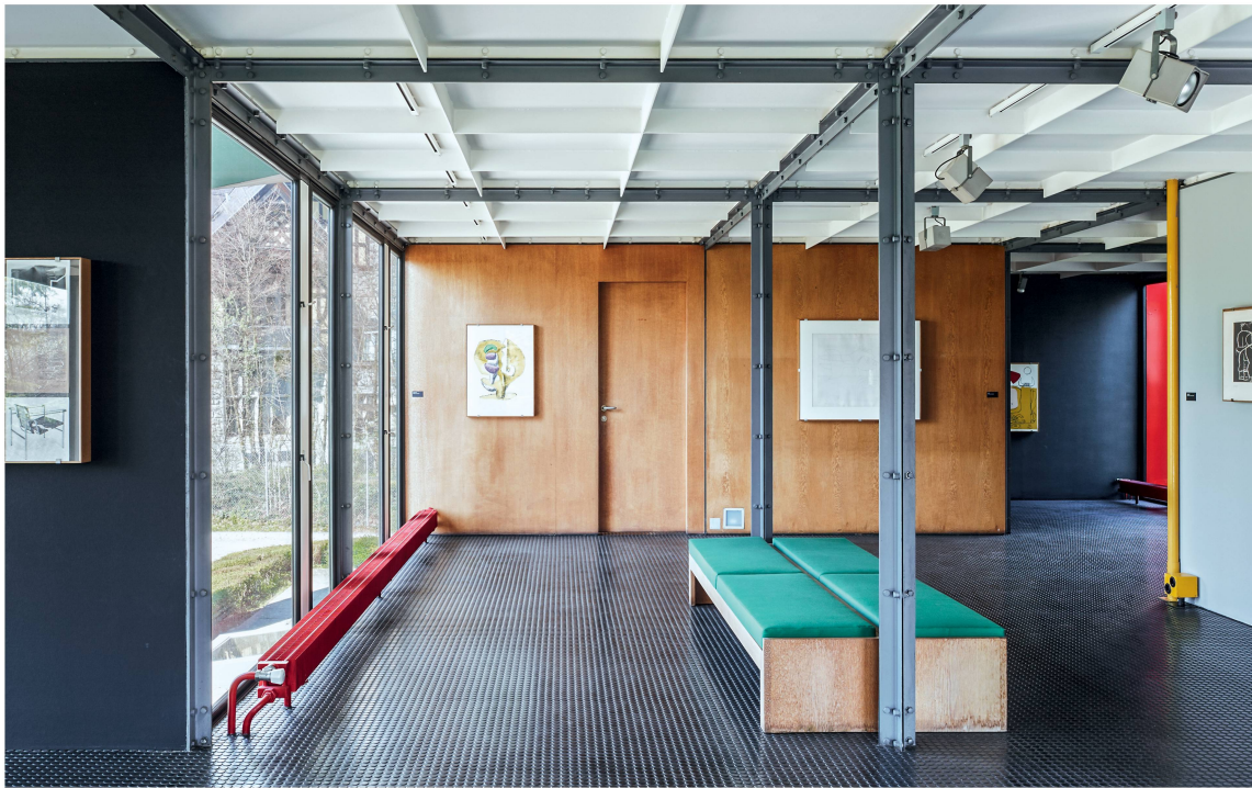
Polychromes Farbkonzept auch bei der Gebäudetechnik: Warm- und Kaltwasserleitungen sind rot und blau gestrichen, die Stromleitungen gelb.
