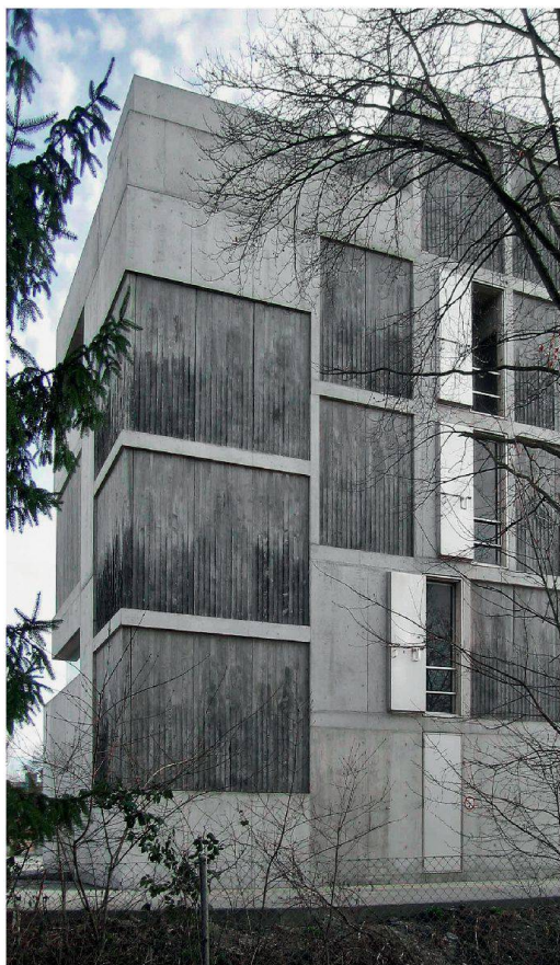
Die Fassade gegen die Grundstücksgrenze hin zeugt von einem Brand, den es hier gar nie gab: Die angekohlten Schalungen hinterliessen Russ im Beton.
