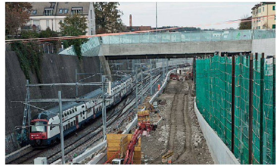
Auf dem neu gebauten Birchsteg werden die Lärmschutzwände aus Glas und Stahl der angrenzenden Stützmauern weitergeführt.
