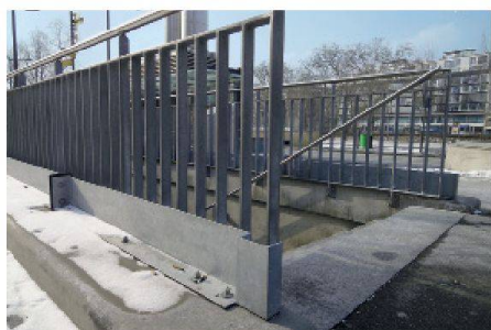
05–06 Die Objekte mit dem grössten Schadenrisiko müssen mit Objektschutzmassnahmen nachgerüstet werden. Im Bild: Abschirmung einer Siedlung durch Mauerelement mit Einlassschiene für Dammbalkensystem (oben) bzw. Abdichtung eines Treppenabgangs mit Blech-aufsatz (unten). (Fotos: Amt für Städtebau)
