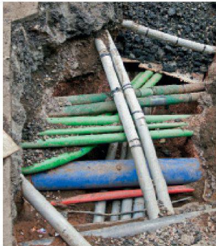
Bevor in die Tiefe gebaut werden kann, ist der genaue Verlauf zahlreicher Werkleitungen abzuklären. (Foto: istockphoto.com)
