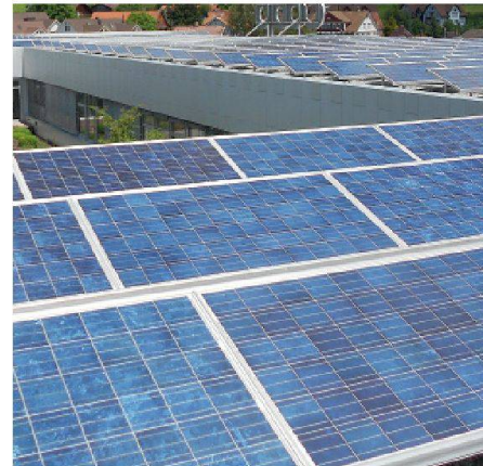
02 Coop-Grossbäckerei und -Verteilzentrale in Gossau SG. (Foto: Schweizer Solarpreis 2012)
