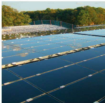
04 Geschäftsgebäude der Entsorgungsgesellschaft Westmünsterland in Gescher (Nordrhein-Westfalen). (Foto: Colexon Energy AG)
