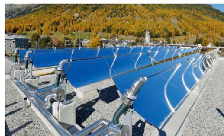
03 Kategorie Anlagen: Auf dem Dach der Lateria Engiadinaisa in Bever GR erzeugt eine 65-kW-Hochtemperatur-Solaranlage Dampf für die Milchverarbeitung und spart so 7000 l Heizöl.
