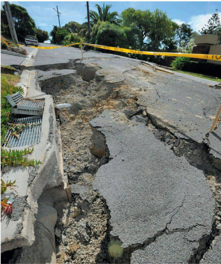
01 In der Sumner Road bei Christchurch ist das Phänomen der Bodenverflüssigung deutlich erkennbar: Sand und Silt verflüssigten sich unter den vom Erdbeben hervorgerufenen Boderschütterungen. Der Boden an leichter Hanglage fliesst talwärts und reisst die Strassendecke auf (Foto: KEYSTONE/MAXPPP/*)
