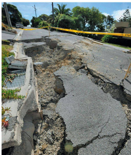
01 In der Sumner Road bei Christchurch ist das Phänomen der Bodenverflüssigung deutlich erkennbar: Sand und Silt verflüssigten sich unter den vom Erdbeben hervorgerufenen Boderschütterungen. Der Boden an leichter Hanglage fliesst talwärts und reisst die Strassendecke auf (Foto: KEYSTONE/MAXPPP/*)
