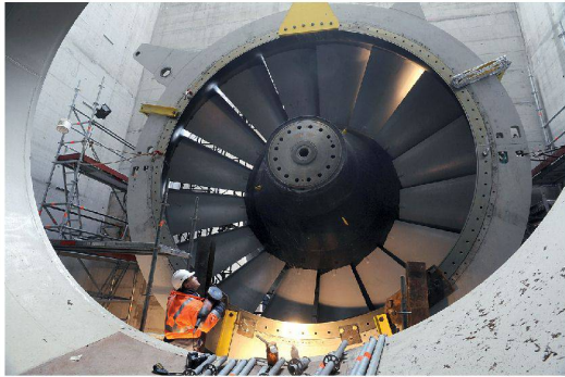
Leitapparat für eine der neuen Turbinen im Kraftwerk Rheinfelden (Foto: Energiedienst AG)
