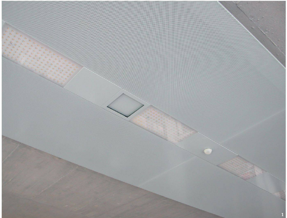
Foto: Professur für Gebäudetechnik
