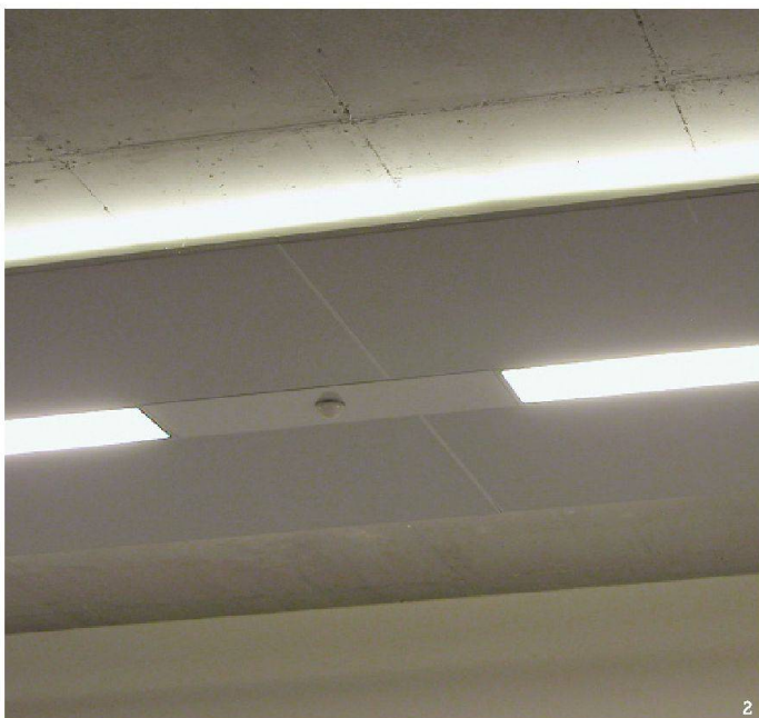
Foto: Professur für Gebäudetechnik
