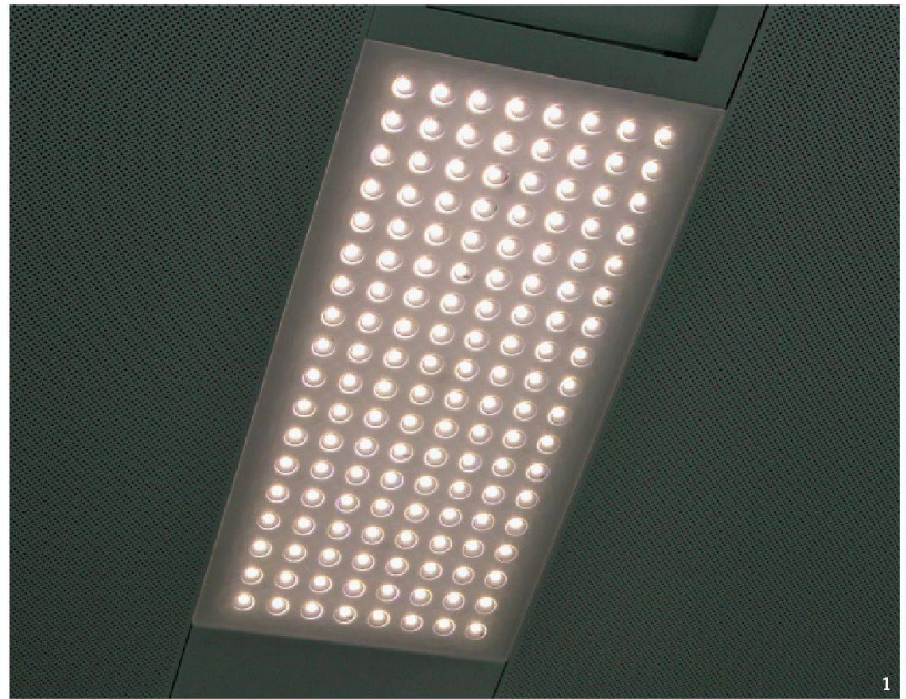
1 Foto: Professur für Gebäudetechnik
