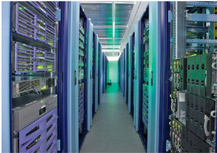
01 Serverraum des Rechenzentrums der Postfinance, Zofingen (Bild: KEYSTONE/Gaetan Bally)
