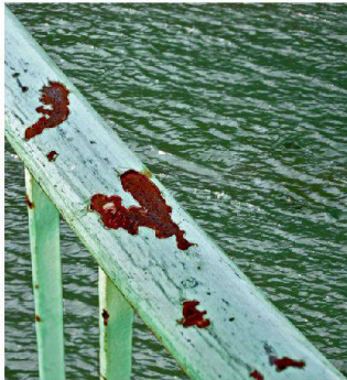
Korrodiertes Geländer einer Brücke, das einer Instandsetzung bedarf (Foto: photocase/Bearbeitung: Red.)
