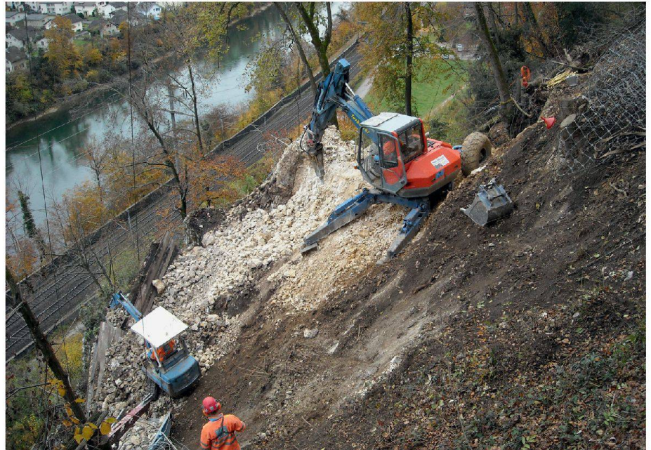
02 Der mechanische Felsabtrag erfolgte mittels Schreitbagger und Hydraulikhammer. Die obersten 12 m des Felspfeilers, die von Hand mittels Presslufthammer abgetragen wurden, sind hier bereits entfernt. Eine Seilbahn erschloss die Baustelle an exponierter Lage (Fotos, Plan und Diagramm: Geotest AG)
