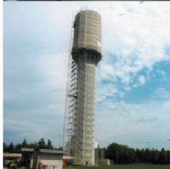
Behälter- und Bäderbau
