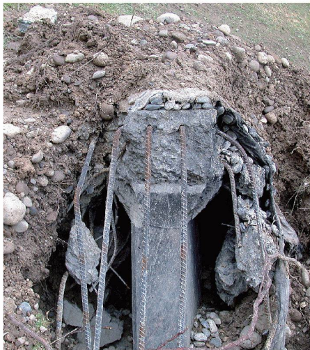
01 Die eingestürzte Decke in Gretzenbach (Bild: Aurelio Muttoni, ETH Lausanne)
