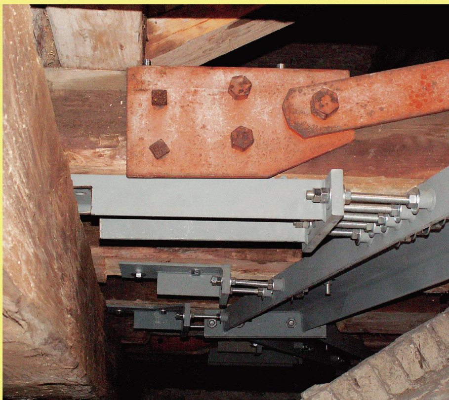
13 Verankerungen eines Stahlrings in den Bundbalken. Das Bild entspricht der Position unten rechts in Bild 10
