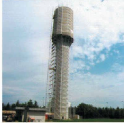
Behälter- und Bäderbau
