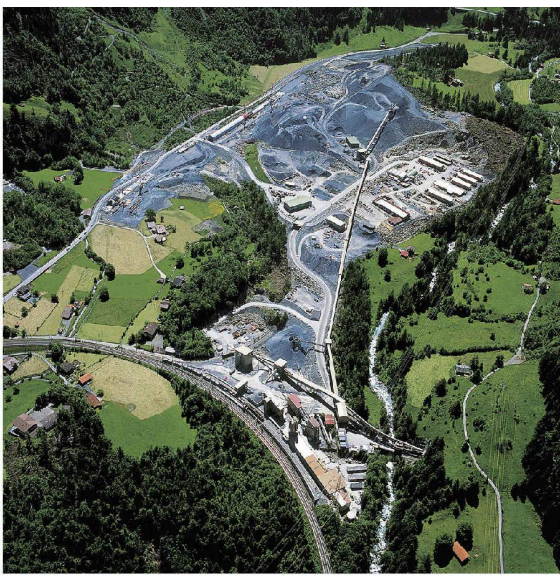
Luftbild der Neat-Baustelle Mitholz. Oben links der Lawinenschutz-Strassentunnel während der Bauzeit, vor der Überdeckung (Bild: BLS Alptransit)
