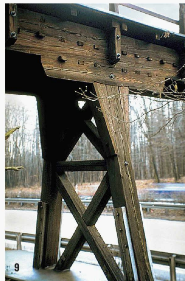
9 Diese 1938 erstellte (und inzwischen abgerissene) Holzbrücke bei Pforzheim erreichte durch einen konstruktiven Holzschutz (Asphaltbelag) eine lange Lebensdauer bei gleichzeitig geringem Unterhalt
