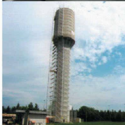
Behälter- und Bäderbau
