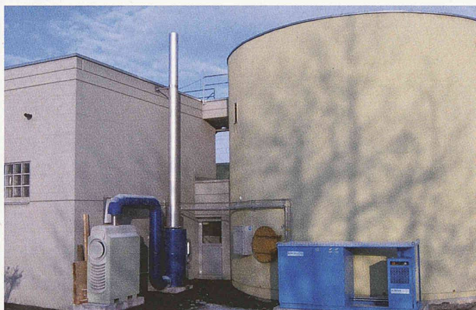
30-kW-Gasturbine der Abwasserreinigungsanlage Frick (Bild: eam)
