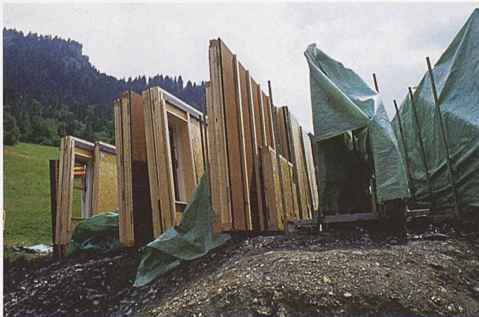
Aus diesen vorgefertigten Elementen wurde das Willimann-Haus (1998–1999) von Bearth & Deplazes in Sevgein GR gebaut (Bilder: www.awonline.net)
