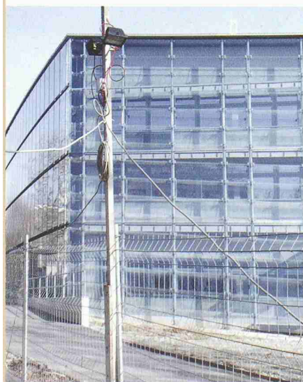
Das Herzstück im Koma: Seit 18 Monaten läuft nichts mehr auf der Baustelle des Intensiv-, Notfall- und Operationszentrums am Inselhospital Bern (Bild: Ivo Bösch/Red.)
