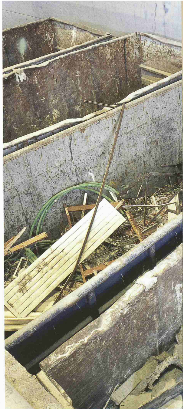
Mit dem Bagger werden Holz, Metall und grober Bauschutt für das spätere Recycling voneinander getrennt (oben), nur Brennbares wird der Kehrichtverbrennungsanlage (KVA) zugeführt. Was nicht mittels Bagger trennbar ist, gelangt via Förderband in den eigentlichen Sortierprozess (unten). Absiebung und Handlese sind die weiteren Schritte. Diverse Anlagen, die seltsam anmutende Namen wie Rüttelsieb, Magnetabscheider und Windsichtung tragen, reduzieren die Handarbeit auf ein Minimum (Bilder: Michael Lio)
