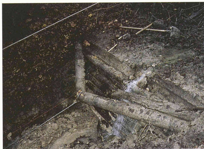
4 Biegebruchversuch an einer einwandigen Holzsperrung. Das Rundholz ist in Balkenmitte und bei der rechten Einbindung gebrochen (in Fliessrichtung betrachtet). Als Kraftquelle diente eine traktorbetriebene Seilwinde
