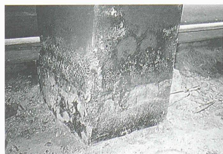
5 Zustand Mittelstützenfuss vor der Instandsetzung
