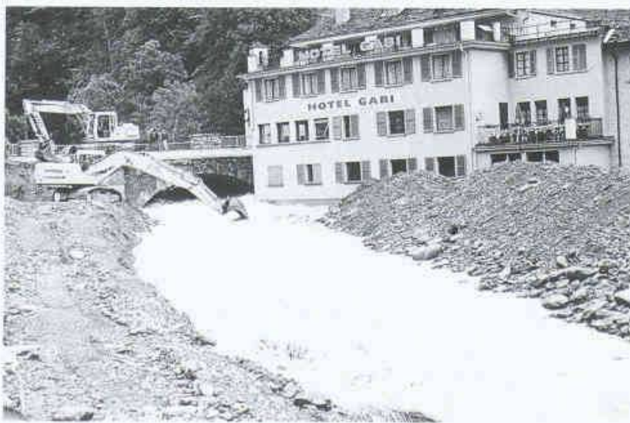
beim Hotel verursachten Sohlenhebungen von mehreren Metern (Photo J. Escher, Simplon-Dorf)
