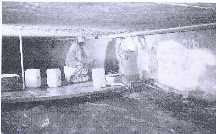
Bild 7. Missliche Arbeitsbedingungen: ständiger Schmutzwassergeruch, knappe Arbeitsverhältnisse bei Höhen von 1,40 bis 1,80 m
