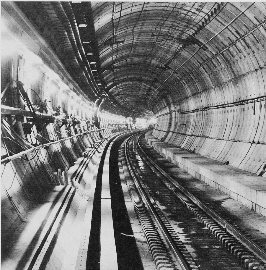
Bild 1. Blick in einen der beiden eingleisigen Eisenbahntunnel mit Stützring aus hochfesten Stahlbeton-Tübbingungen und beidseitigen Randwegen, kurz vor der Inbetriebnahme
