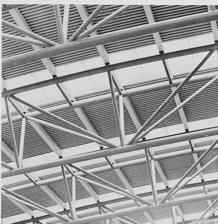
Bild 4. Die geschwungenen Hauptbinder sind als Rohrfachwerke mit Dreiecksquerschnitt zwischen den Hauptrohren ausgebildet
