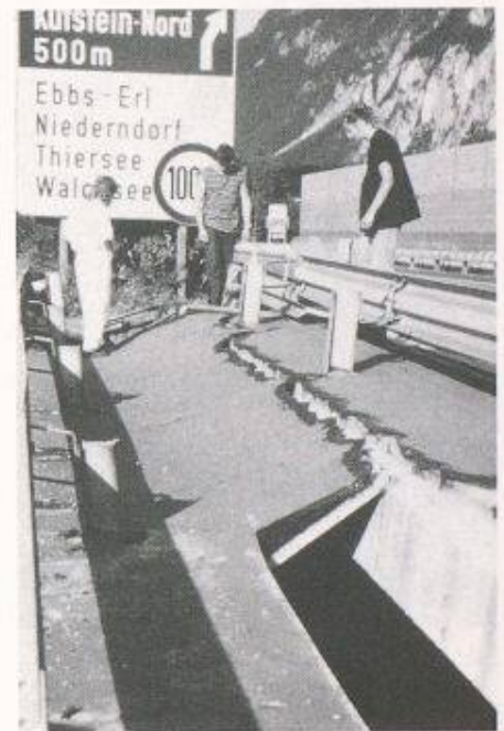
Bild 1. Inntalbrücke bei Kufstein nach dem Schadensfall
