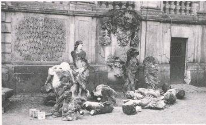
Bild 4. Steinkrebs: nicht Kriegsfolgen, sondern eine unglaubliche Luftverschmutzung führten zu diesen Zerstörungen im berühmten Dresdner Zwinger. Wertvolle Bausubstanz in der ganzen ehemaligen DDR, sofern sie den Krieg und spätere ideologisch motivierte Abbrüche überlebt hatte, ist nun durch Umweltschäden bedroht
