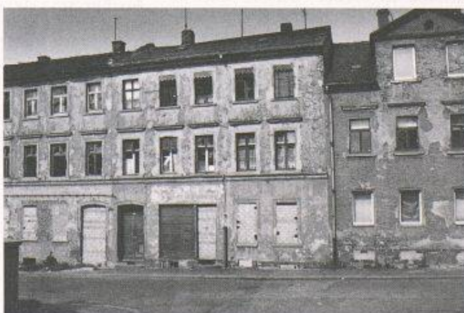
Bild 2. Mangel an Unterhalt infolge unrealistisch tiefer Mietzinsse hat einen beispiellosen Zerfall der Bausubstanz bewirkt. Undichte Dächer lassen zunächst die oberen Geschosse unbewohnbar werden; mit der Zeit schreitet die Aushöhlung weiter nach unten fort, bis schliesslich der ganze Bau aufgegeben werden muss
