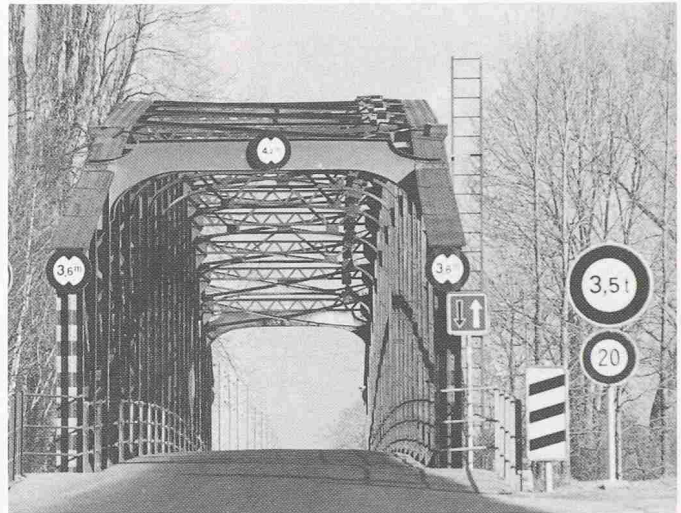
Bild 4. Einschränkungen vor der Erneuerung
