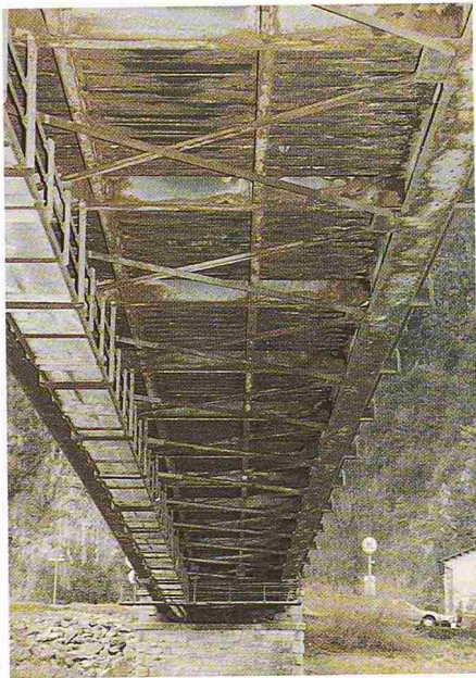
Bild 6. Verrostete Untersicht der Brücke
